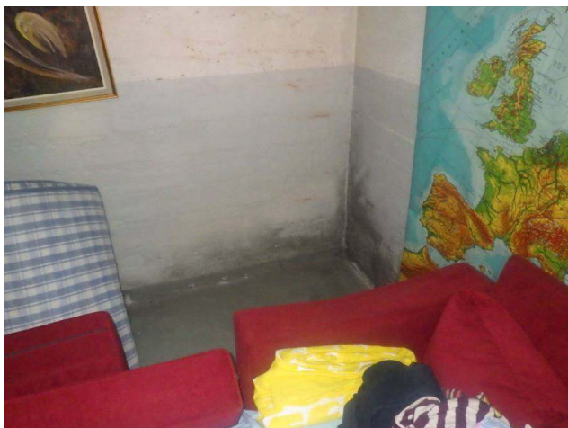
9. Kosteusjälkiä seinän alaosassa kellarin "makuuhuoneessa"
