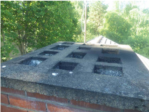
30. Piipun päällä ei ole sadehattua
