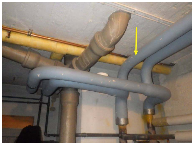
57. Teknisessä tilassa kulkevissa putkieristeissä voi olla asbestia
