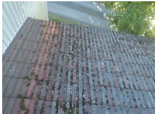
25. Tiilikatteen pinta on paikoin sammaloitunut
