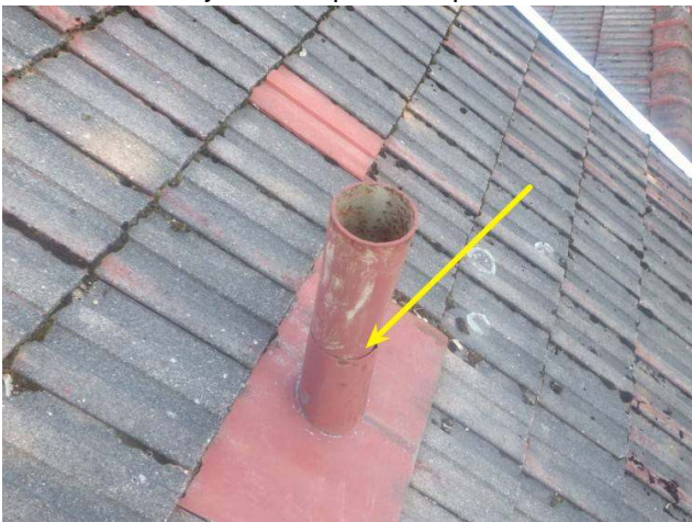
28. Viemärin tuuletusputken läpiviennin juuripellitys on epätiivis
