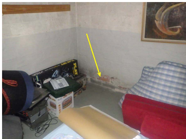
8. Kellarin "makuuhuonetta", kosteusjälkiä seinän alaosassa
