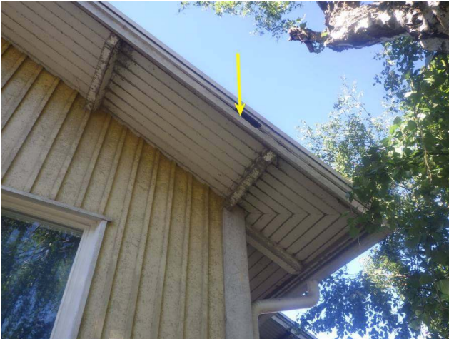
20. Räystään otsalaudassa on lahovaurio
