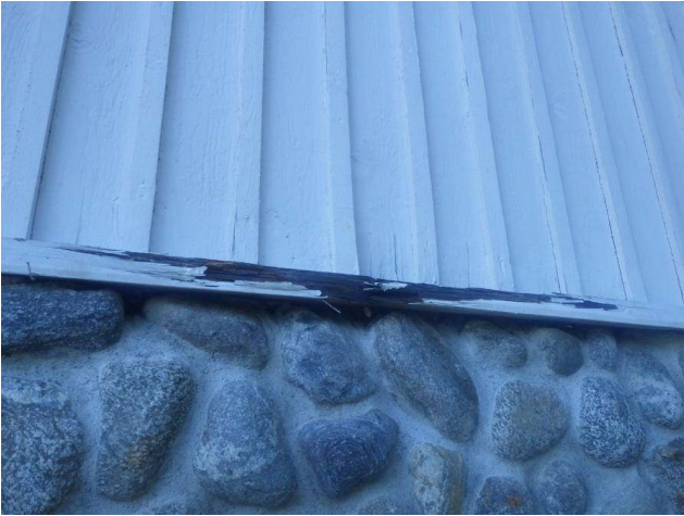
18. Lahovaurio puuverhouksen alaosan tippalistassa
